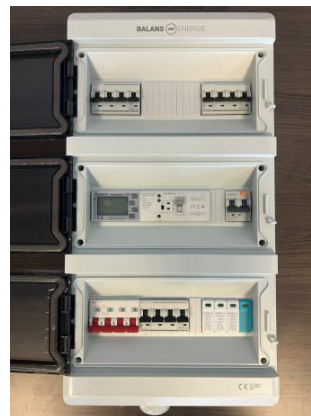
Off-grid kast van de installatie.
