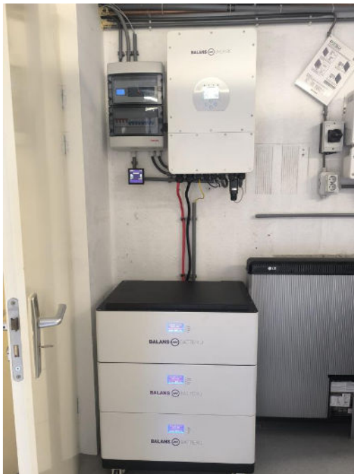
Voorbeeld van een off-grid v2.0 installatie.
