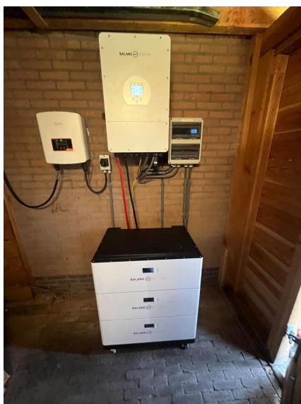
Voorbeeld van een off-grid v1.1 installatie.
