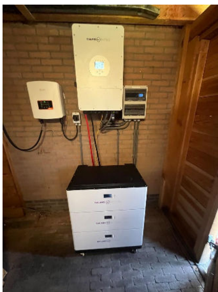
Voorbeeld van een off-grid v1.0 installatie.
